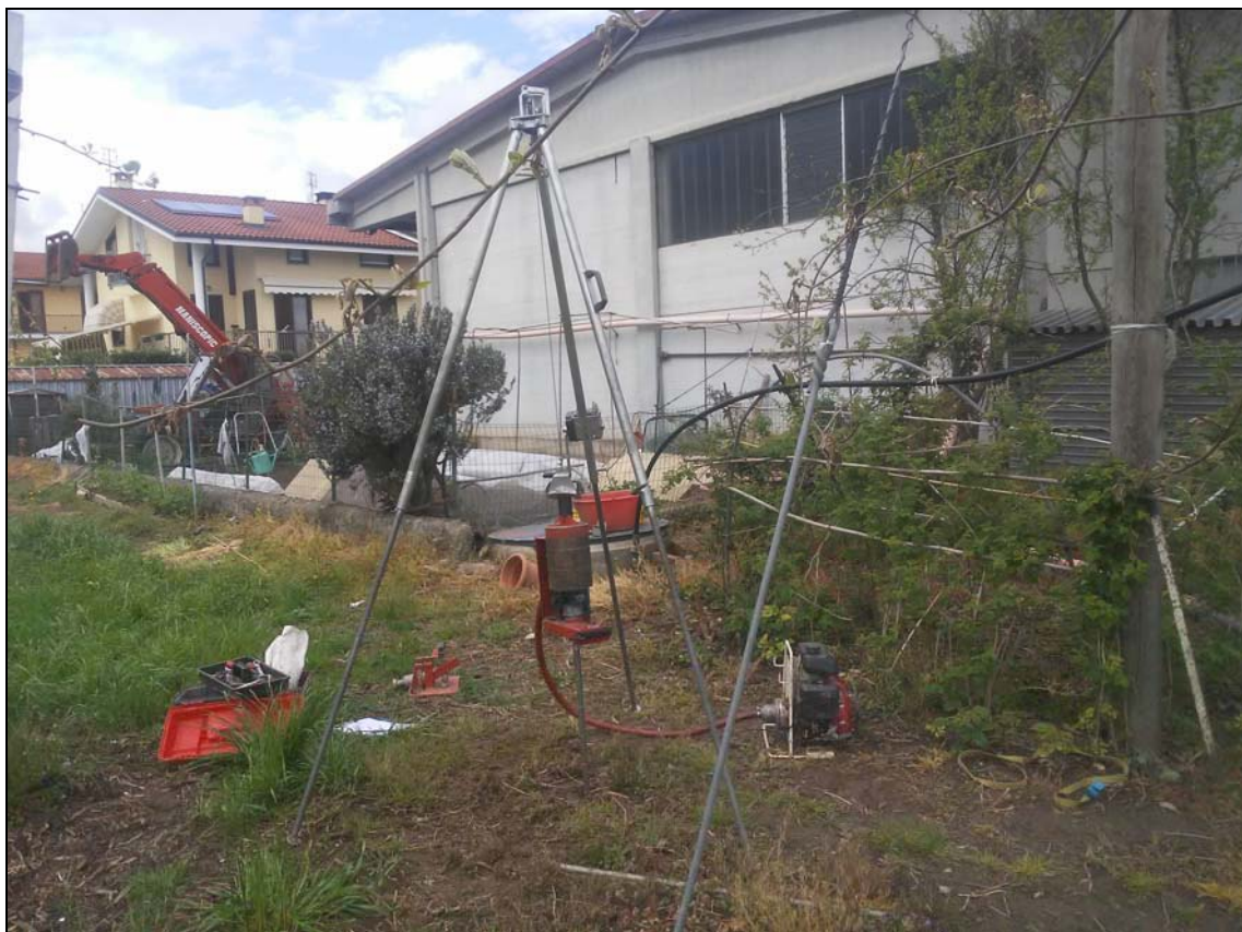
Figura 5: immagine fotografica della strumentazione utilizzata per la realizzazione della prova penetrometrica PP1-BAR-FAR nell'area di intervento.
